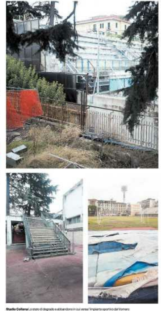
Stadio Collana: in stato di degrado e abbandono in cui versa l'impianto dopo 10 anni...
